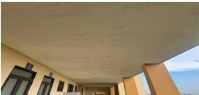
Hình 3.15. Trần hành lang khoa Y Dược nhà C bị loang ố ẩm mốc
