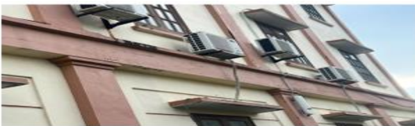
Hình 3.8 Nứt và gỉ sét tại khu vực lắp điều hòa nhà hiệu bộ A
