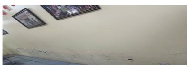
Hình 3.12. Chân tường phòng học nhà B bị ẩm mốc loang màu thấm nước
