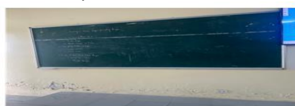
Hình 3.14. Bong tróc tại nền tường phòng học giảng đường nhà B
